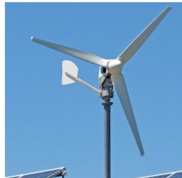
Slika: Primer vetrne elektrarne 3,5 kW za samooskrbo
